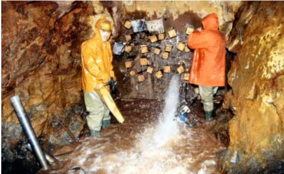
Wasserlösung im Rothschönberger Stollen (Dezember 2003) (Foto: Jens Kugler)
