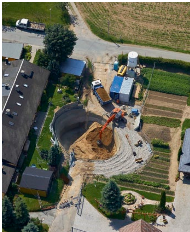
Tagesbruch Dörfler Weg in Annaberg-Buchholz – Beginn Aufwältigung und Sicherung
