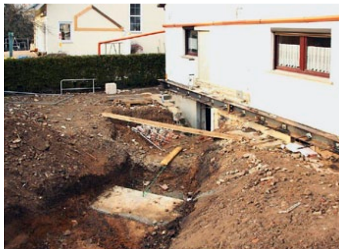
Akute Rissbildung an einem Wohnhaus in Brand-Erbisdorf nach Setzungsereignissen an einem Schacht mit unbekanntem Verwahrzustand
