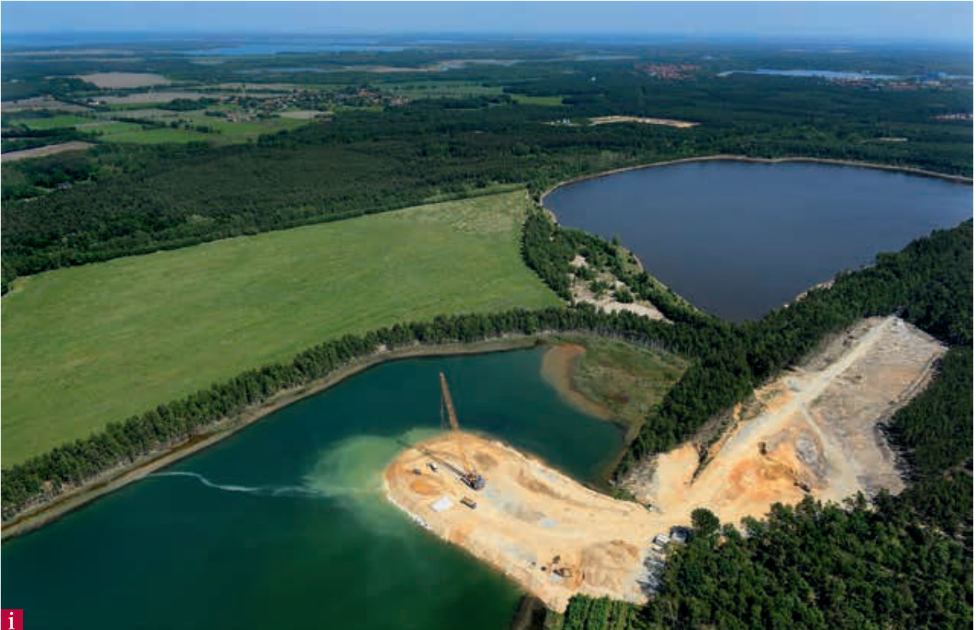
i Errichtung standsicherer Trenndamm im Restloch Heide VI (Brandenburg) zum Schutz des Restloches Heide V (Sachsen)
