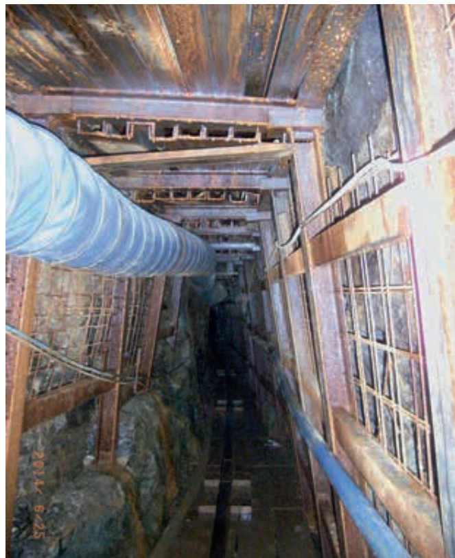
Stahlausbau im Grubengebäude Breitenbrunn
