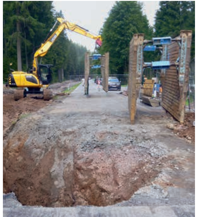
Erkundung des Tagesbruchbereiches an der S 272 in Wildenthal
