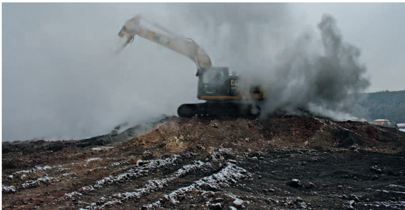
Vielfältige Präventionsmaßnahmen erwartet das Sächsische Oberbergamt auch in der EFRE-Förderperiode 2014 bis 2020 – hier: Sanierung einer brennenden Steinkohlenhalde
