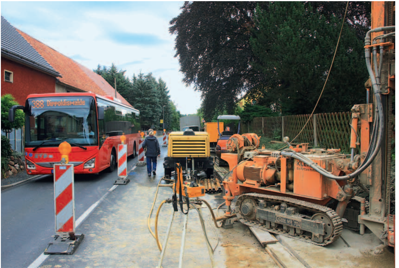
Bohrerkundung zu Hohlräumen unter der Glashütter Straße in Dippoldiswalde
