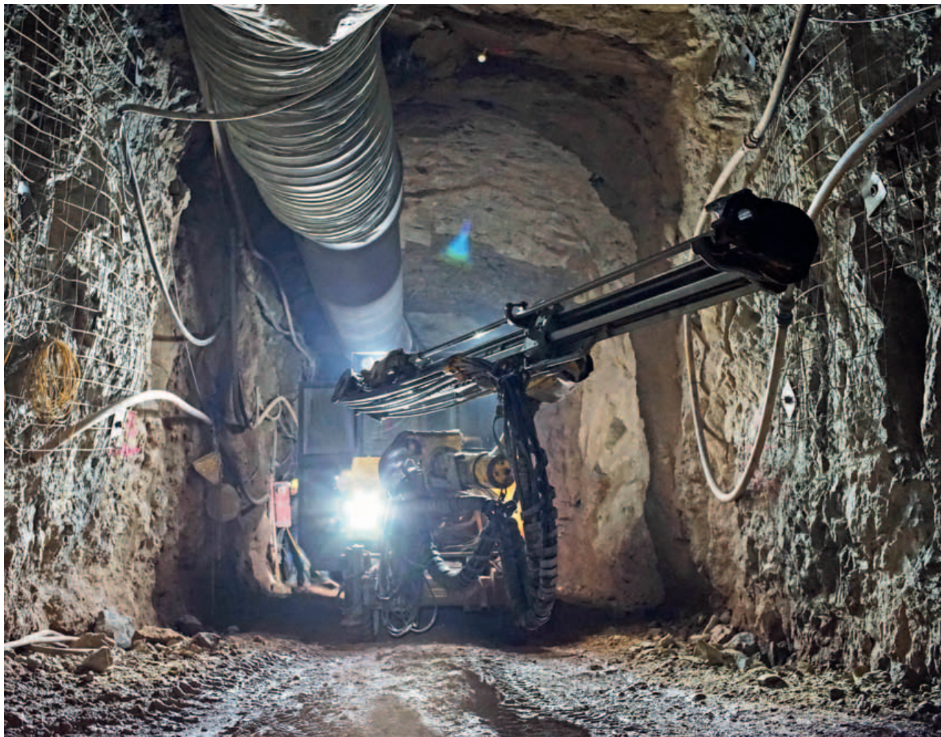
Flussspatgrube Niederschlag – Bohrwagen Atlas Copco S1D
